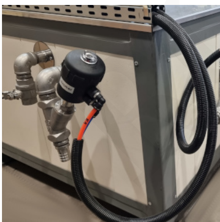
Automatisk kaskade mellom prosesser - styrt av pneumatiske ventiler
